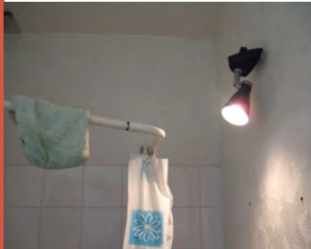
Branchement électrique dangereux
