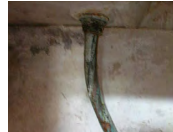
Absence de siphon
