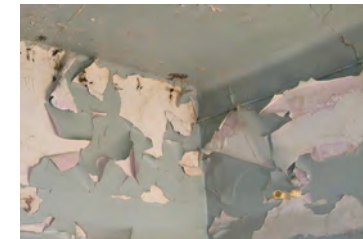
Peinture écaillée contenant du plomb
