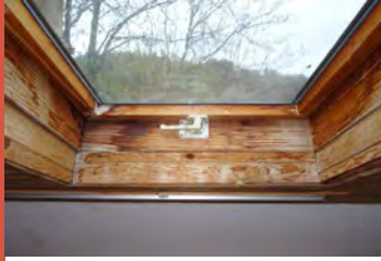
Absence de protection contre les infiltrations d'eau
