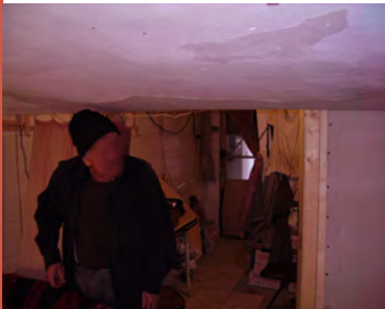
Hauteur sous plafond insuffisante
