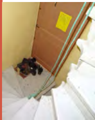
Absence de dispositifs de retenue des personnes
