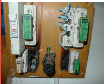
Branchements d'électricité vétustes
