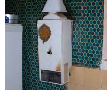
Absence de dispositif d'évacuation des gaz brûlés
